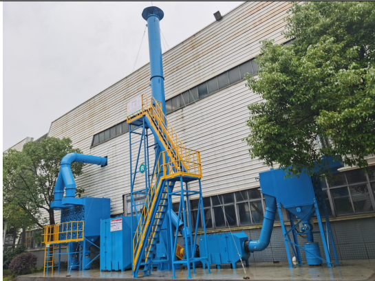
DA030 排气筒（布袋除尘+活性炭吸附装置）
